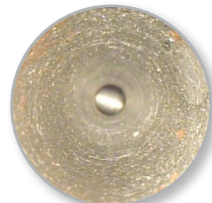
Ablagerungen im Rohr
