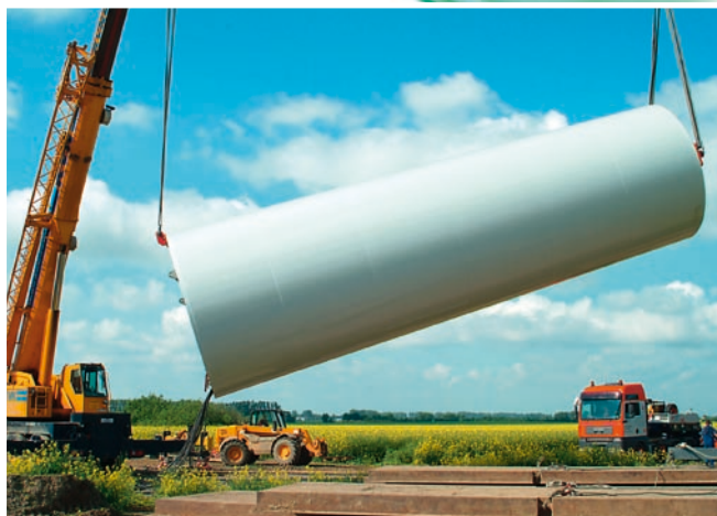
Windkraftanlage im Aufbau: Ein Segment des Stahlrohrturmes wird hier für die Montage vorbereitet.
